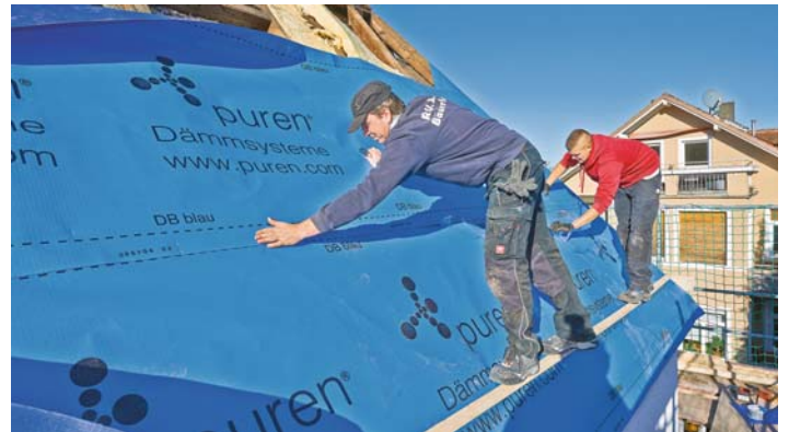
Zu einer perfekten Dämmung gehört nicht nur das eigentliche Dämmmaterial, sondern gehören auch weitere Schichten, etwa Dachbahnen zum Feuchteschutz. (Foto: djd/puren)
