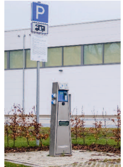
Hinter dem LOHNEUM an der Vechtaer Straße finden Wohnmobile Anschlüsse für Strom und Wasser.
