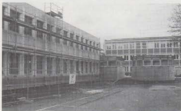
Baustelle mit Rondellen: Beim Collège Capitaine Dreyfus wird im Schulhofbereich der Baufortschritt deutlich. (Fotos: Steinke)
