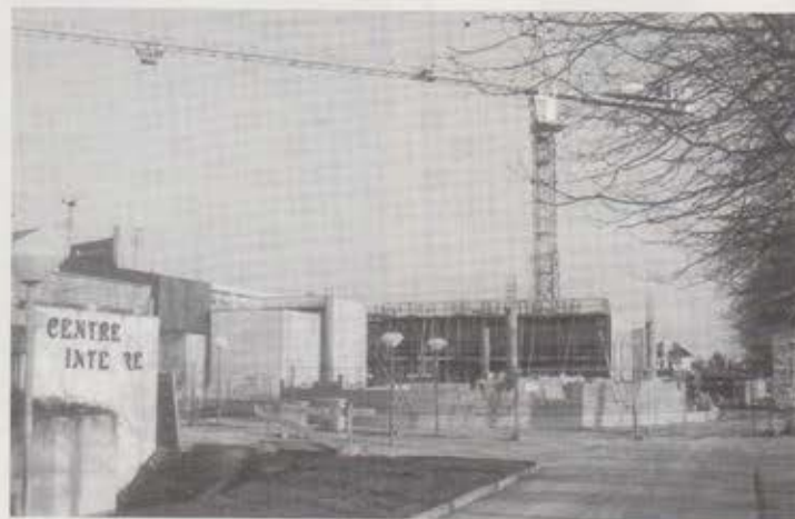
Noch ist er zu lesen, der Schriftzug „Centre Intégré“ doch die Stunden waren gezählt. Inzwischen ist der 1978 errichtete Komplex komplett abgerissen - und teilweise schon im Wiederaufbau. (Foto: Steinke)
